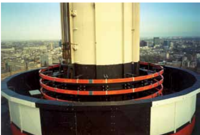
4 замкнутых изогнутых токопровода для вращающегося лифта
