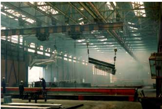
Питание и управление мостовых кранов в гальваническом цехе
